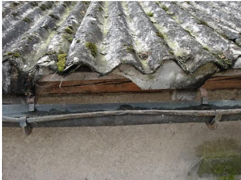
Stark verwittertes Asbestzementdach
