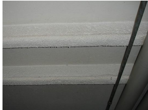
Spritzasbest (Spray auf Stahlträgern)
