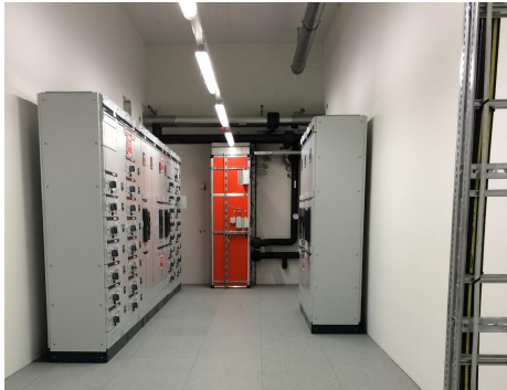
Elektrischer Betriebsraum (Laborgebäude)
