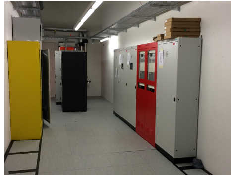
Elektrischer Betriebsraum (Laborgebäude)
