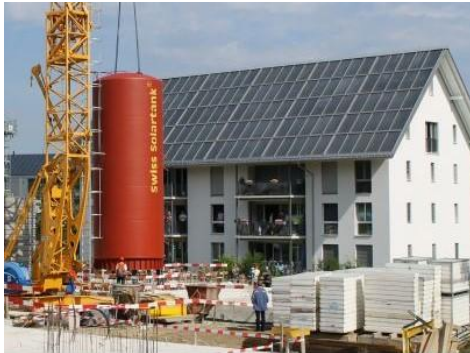
8-Familien-Sonnenhaus mit einer Kollektorfläche von 168 m 2 Solarwärme und 108 m 3 Wärmespeicher [Jenni Energietechnik AG]
