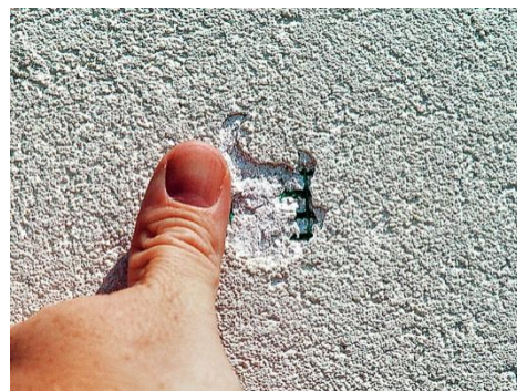
Beschädigter Putz einer Fassade
