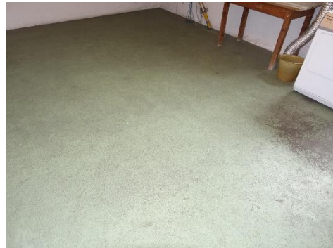
PCB haltiger Bodenfarbanstrich
