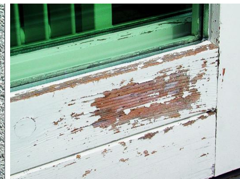
Farbschäden an Holzteilen
